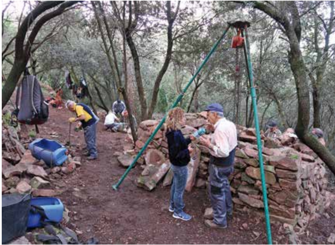
Dimarts passat, el Grup de la Pedra Seca seguia treballant en la restauració de la Barraca Simeó Caba. || J. BATALLA
