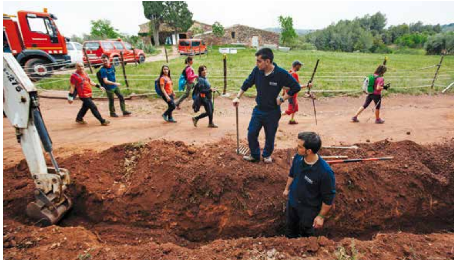
Membres del SERNA treballen en la bassa de Can Padró per trobar una fuga d'aigua i segellar-la. || Q. PASCUAL
