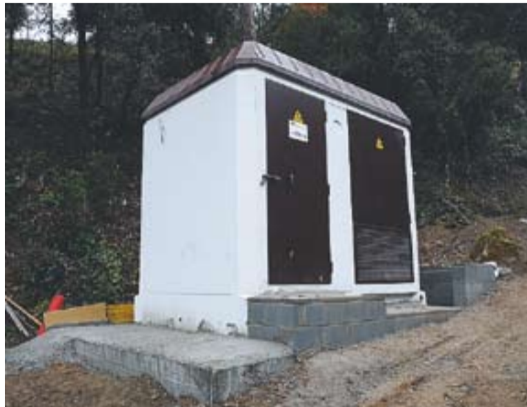
© L'estació transformadora del carrer Licorella. || JOSEP GRAELLS
