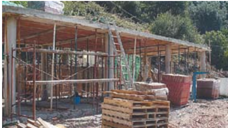
© La construcció que el consistori obliga a enderrocar a la zona del Rieral. || CEDIDA
