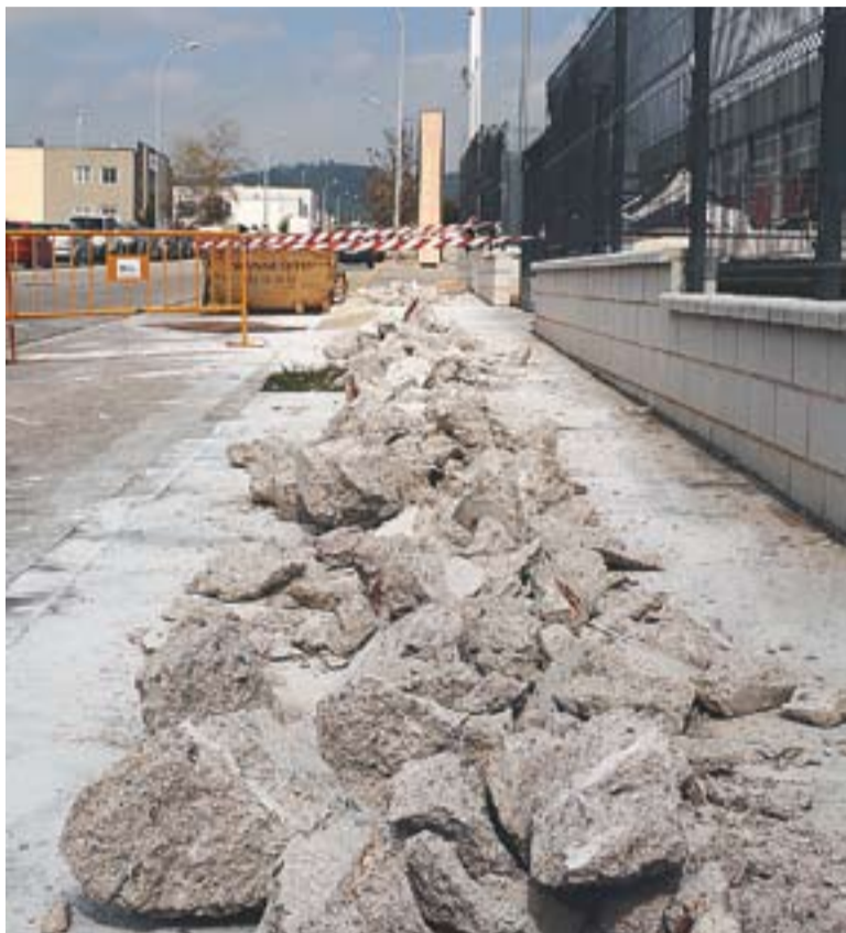
© La primera rasa s'ha obert entre el Centre de Serveis i el Parc de Bombers. || JG
