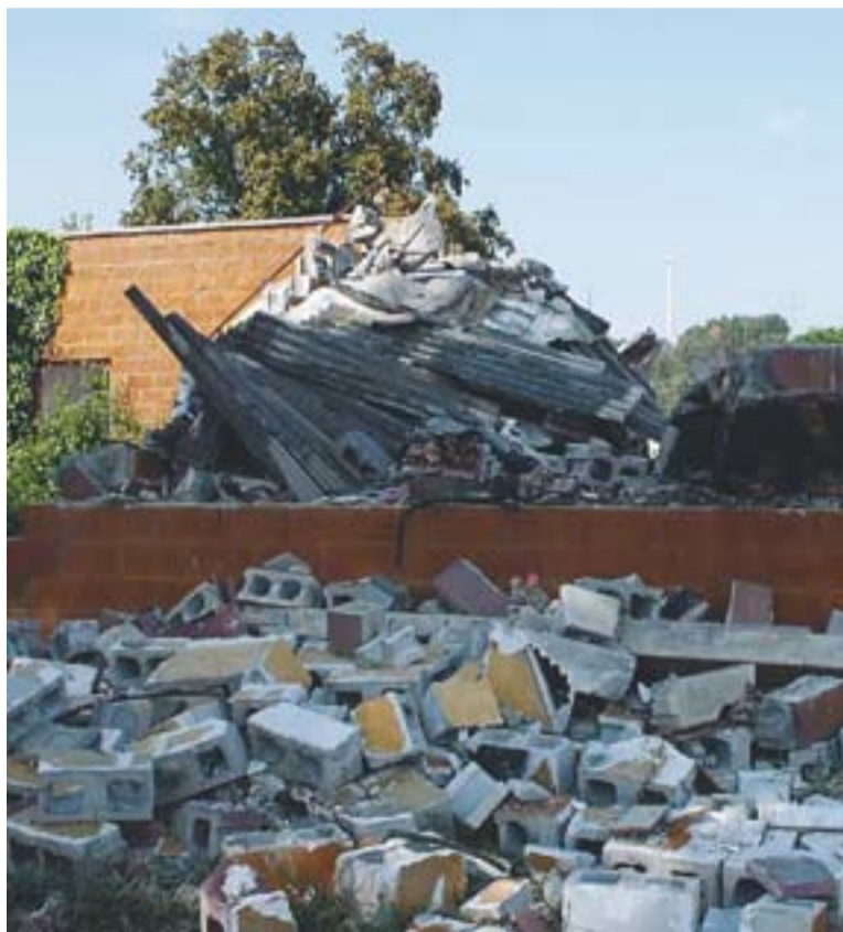
© Imatge d'una zona de Can Bages, amb la runa acumulada. || L'ALTRAVEU
