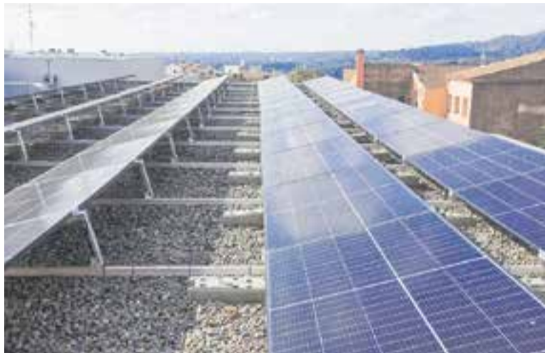
Plaques fotovoltaïques instal·lades al terrat de l'edifici d'El Mirador. || AJ. CASTELLAR
